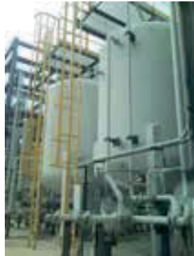
Figura 1. Piping in materiale composito
